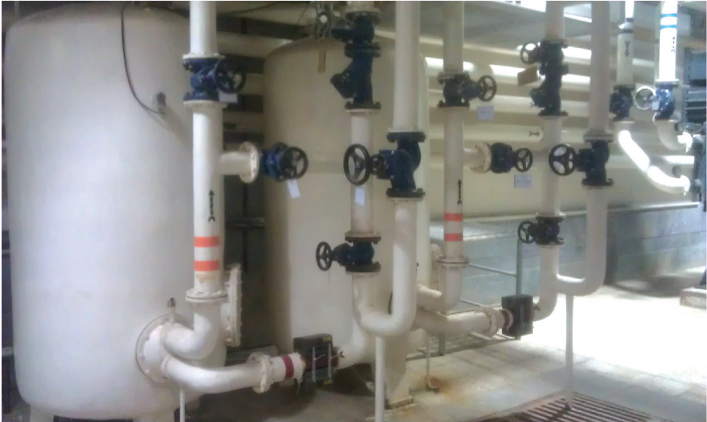
شکل ۱۷- مخازن آب گرم ساختمان گاز استان اصفهان
